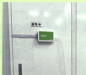
配電盤にポータブル通信電流計を設置（電気工事不要）
